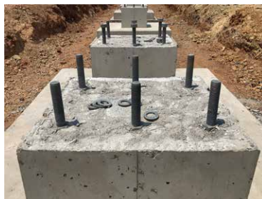
圖 5：建築立柱用的錨固螺栓
